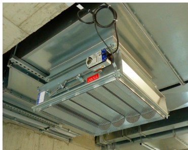
Abb. 2 und Abb. 3 Rauchabzugstaster und Rauchabzug im Gebäude
